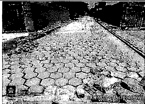
3.8 EXECUÇÃO DE PAVIMENTO EM PISO INTERTRAVADO - RUA DO NORTE, BAIRRO CIDADE NOVA
