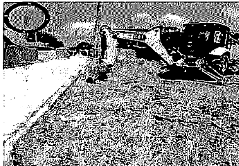
3.5 EXECUÇÃO DE SARJETA DE CONCRETO 3.1 Lastro de areia comercial - RUA 29, BAIRRO CIDADE NOVA
