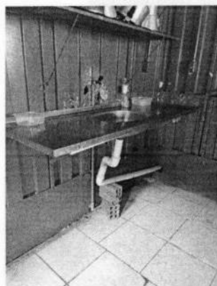
Figura 23 - Parede da copa container furada
