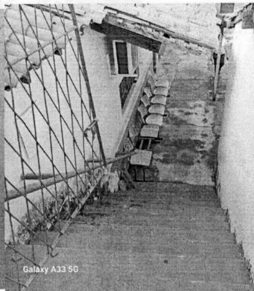
Figura 47 - Acesso aos fundos sem faixas de segurança
