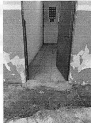
Figura 20 - Acesso baixo às salas facilitando inuncação em grandes chuvas
