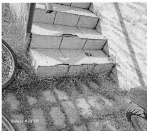
Figura 24 - Escada de acesso lascada
