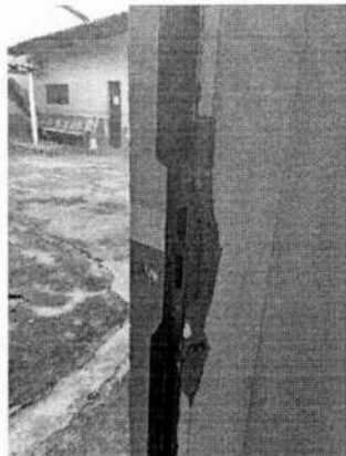
Figura 19 - Fechadura frouxa e parede quebrada
