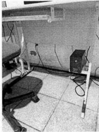
Figura 17 - Umidade nas paredes e falha na pintura
