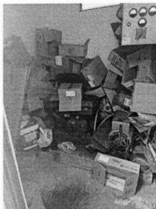
Figura 21 - Gerador estragado e sua casa de máquina virou depósito
